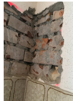
EG - 2.OG Anschluss zu Aussenwand nur 3-4 Steine im Verband gemauert
