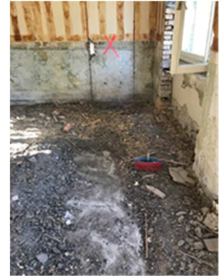
Schwächung durch zusätzliche Öffnungen, Längswand ungenügend gehalten
