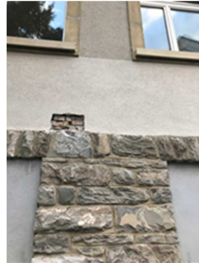
Pfeiler in Fassade Ungenügend gehalten
